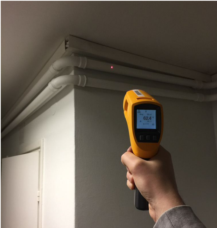
Kuva 2: Eristämätön lämpöjohto eteisessä 103
